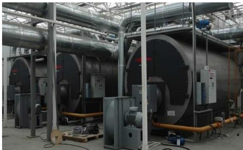
Рисунок 1.5 – Котел системи опалення
